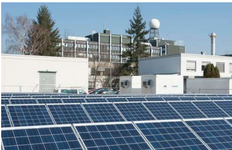
Der Strom aus der Photovoltaikanlage wird zu 100 Prozent im eigenen Netz des KIT verbraucht. (M. Lober/KIT)
