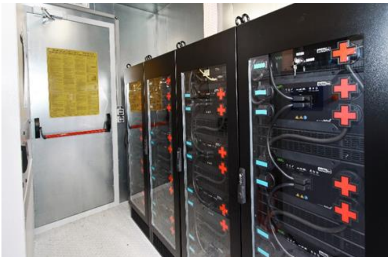
In den Batterien wird der Solarstrom gespeichert und nach Bedarf in das Betriebsnetz des HIU eingespeist. (Foto: Frederik Elschenbroich, ads-tec)
